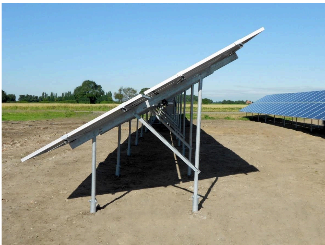
Obr. č. 19 – Fotografie nosné konstrukce pro FV panel 2x 550Wp vrtaná
